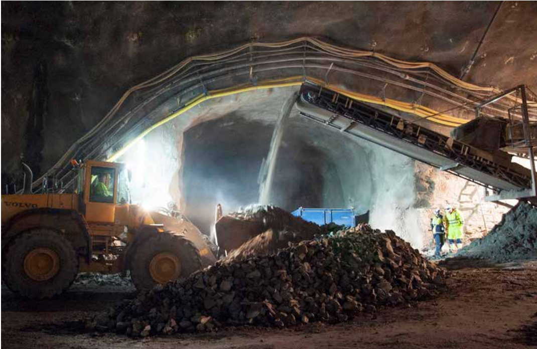
Med hjälp av mobila krossar kan bergmaterial tillverkas på plats och man undviker onödiga transporter.
