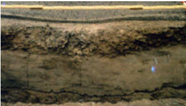
Figur 12. Exempel på spårbildning förorsakad av sättningar i vägkropp med a) uppsprickning av bitumenbundet slitlager och b) sättningar i överbyggnadslager.
